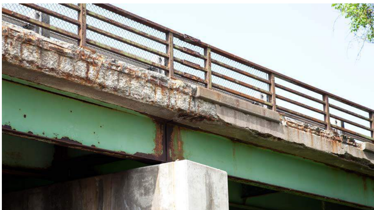
Ενανθράκωση σε γέφυρα δρόμου ταχείας κυκλοφορίας.
