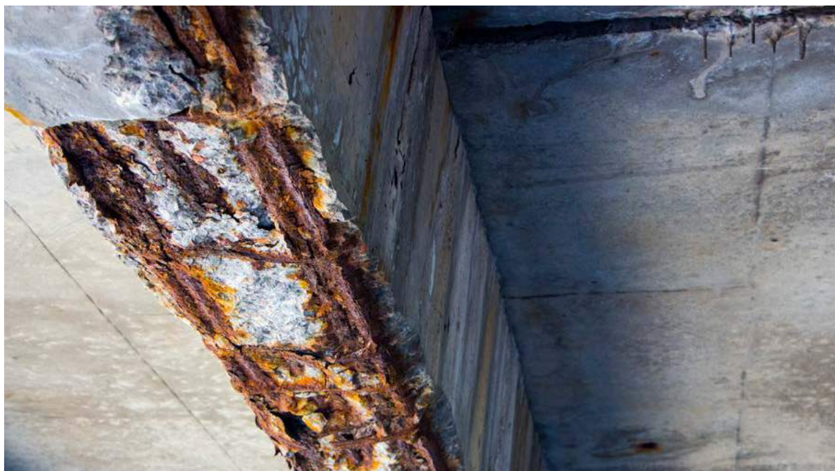
Κατεστραμμένη δοκός στήριξης γέφυρας (κοντινή λήψη).
